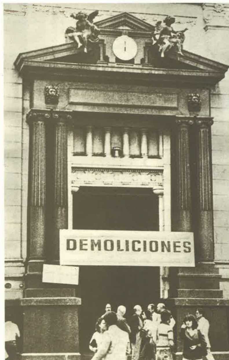
Ochava, que contiene la puerta de ingreso, cuando comenzó la demolición del sector.
